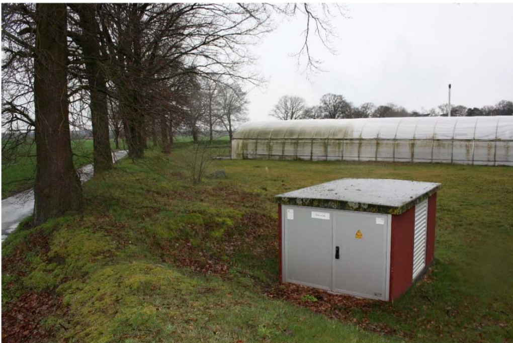
Abbildung 2.8: Pflanzzelle und Trafostation im östlichen Teil des Bebauungsplangebietes sowie Eichenbewachsener Bodenwall am Weg „Wulferhook“
