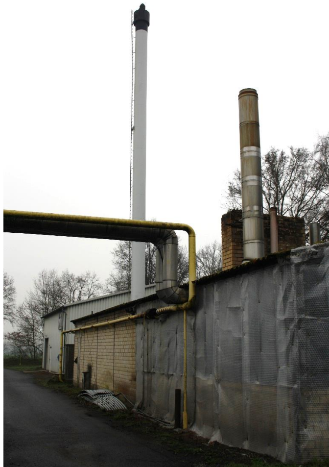
Abbildung 2.6: Gebäude mit Heizungsanlage
