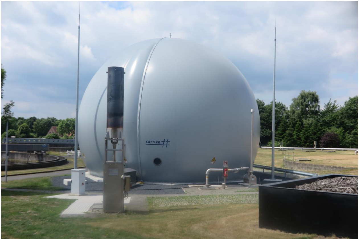
Neuer Gasspeicher auf der Kläranlage
