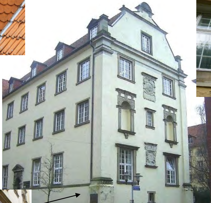
Massive Schäden am Dach
