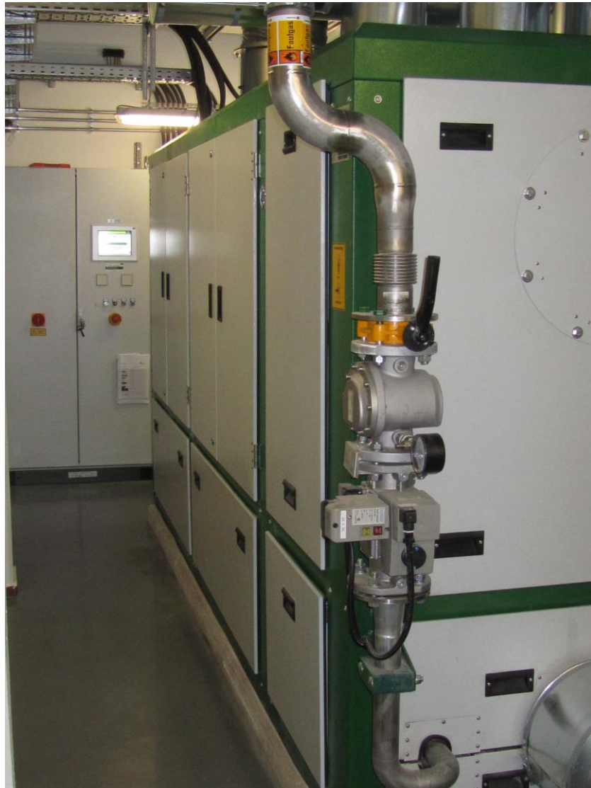
Neues BHKW auf der KÄranlage
