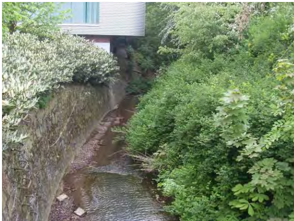
Abbildung 40: Sehr tief eingeschnittene Fegetasche mit Sohlverbau im Bereich unterhalb der Daruper Straße
