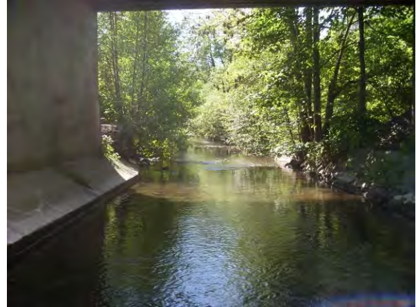
Abbildung 21: Eisenbahnbrücke mit Wasserbausteinen und Schutt
