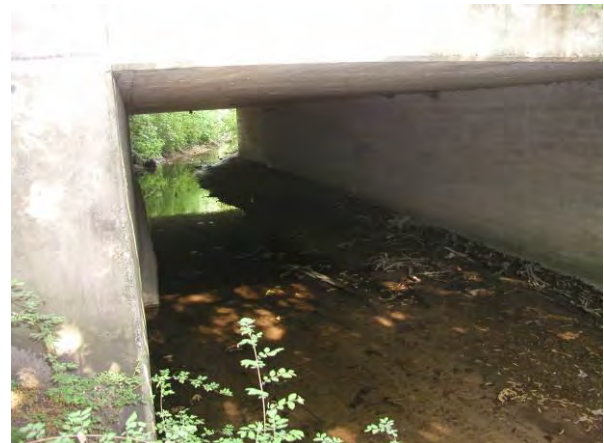
Abbildung 41: Durchlass mit sandiger, teils lehmig-schlammiger Sohle, im strömungsarmen Bereich liegen Äste
