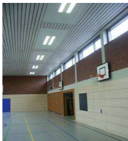
TH Kreuzschule, Deckenstrahlheizung + integr. Beleuchtung
