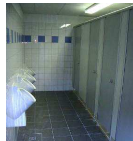
Heriburg-Gymnasium, wasserlose Urinale
