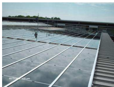
PV-Anlage auf dem Dach der Feuerwache Coesfeld
