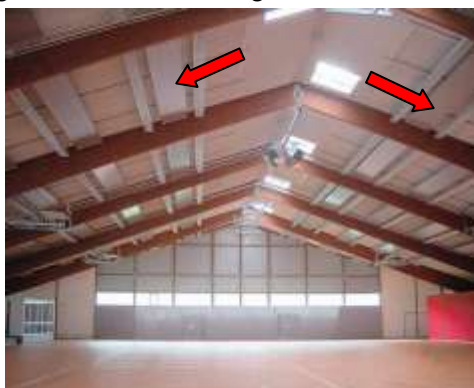
Sporthalle mit Deckenstrahlheizung
