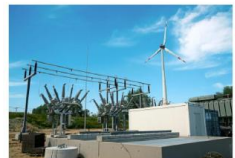
Windräder, PV-Anlagen, eine Biogasanlage und ein Umspannwerk: Alles innerhalb weniger Meter.
