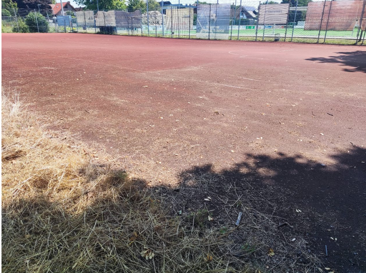
Foto: Stark sanierungsbedürftige Basketballfläche Reiningstraße 12
