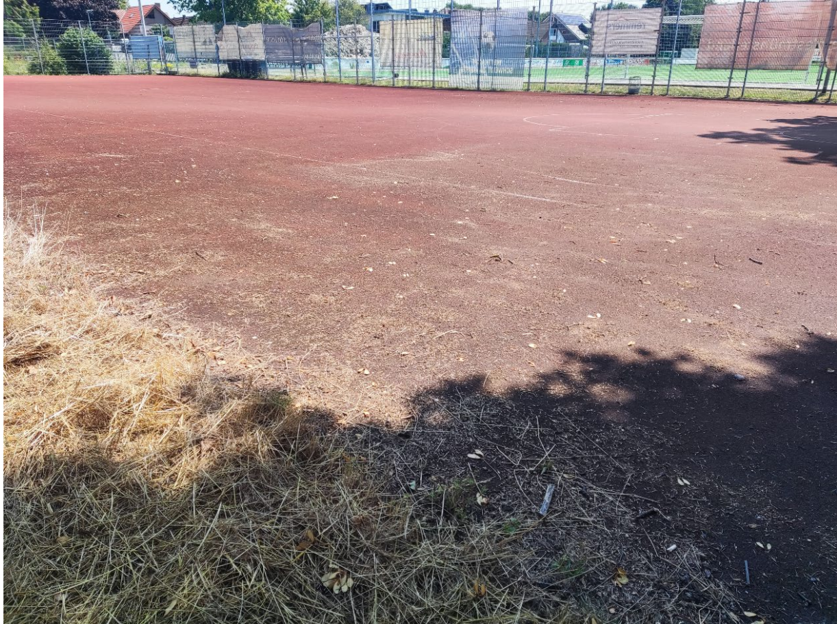
Foto: Stark sanierungsbedürftige Basketballfläche Reiningstraße 12
