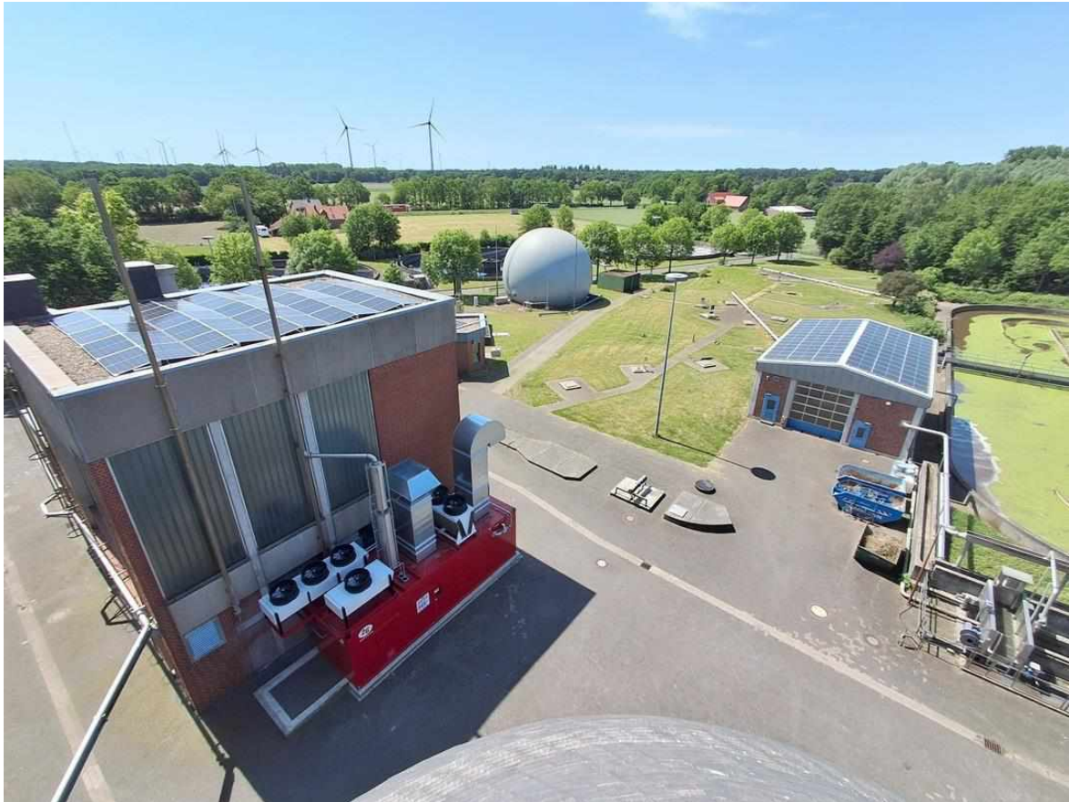
Photovoltaik und BHKW Kläranlage
