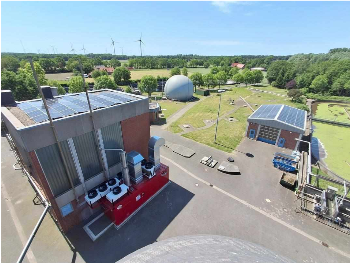
Photovoltaik und BHKW Kläranlage
