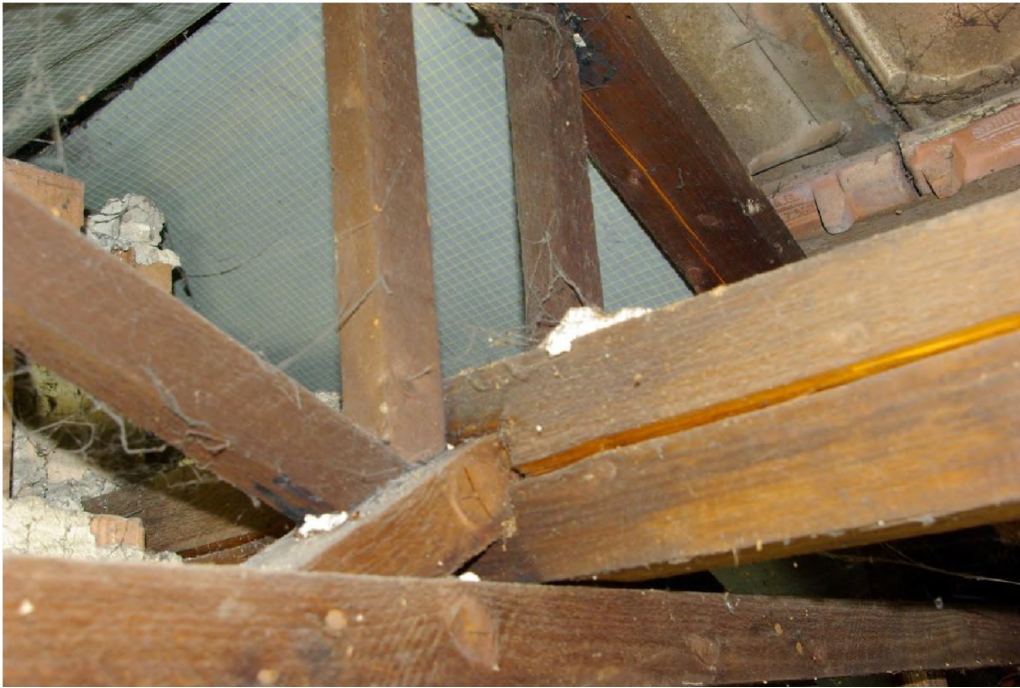
Abb. 7 Detailpunkt Fachwerkkonstruktion mit Rissen
