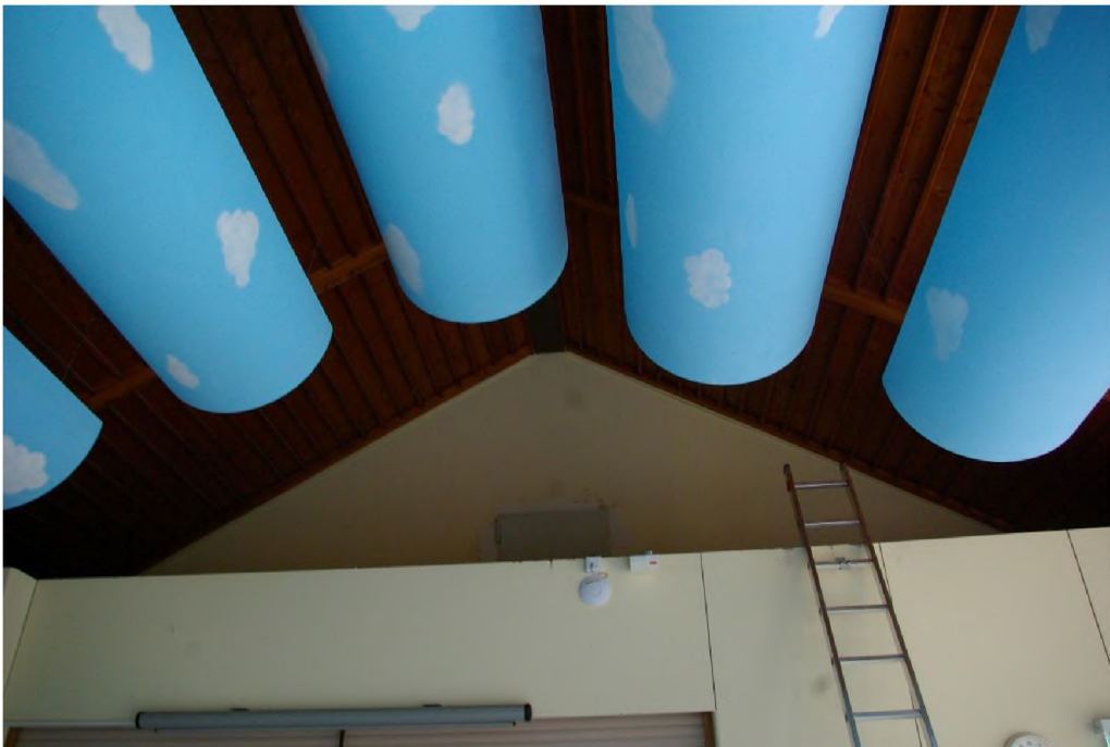
Abb. 8 Unterdecke vorhandene Aula mit Akustikelementen
