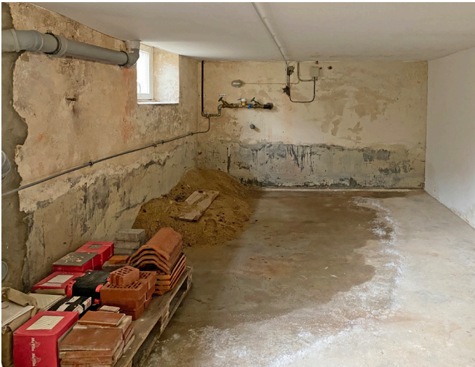
Nicht alle Außenwände sind gegen eindringende Feuchtigkeit isoliert. In einem angrenzenden Kellerraum tritt Wasser ein.
