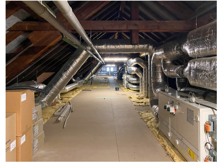
Im Dachgeschoss des Altbaus befindet sich die Lüftungstechnik.
