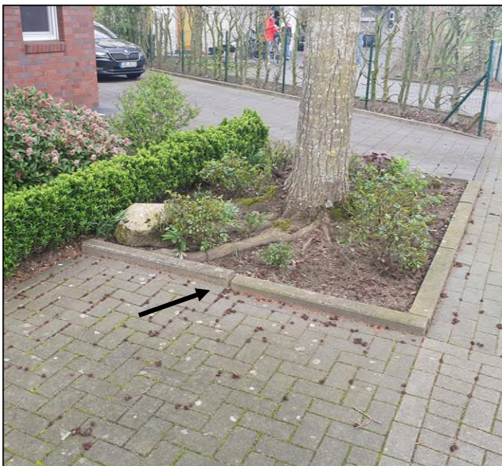
Anhebung der Betonkante durch Baumwurzeln
