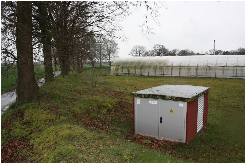
Abbildung 2.8: Pflanzzelle und Trafostation im östlichen Teil des Bebauungsplangebietes sowie Eichenbewachsener Bodenwall am Weg „Wulferhook“
