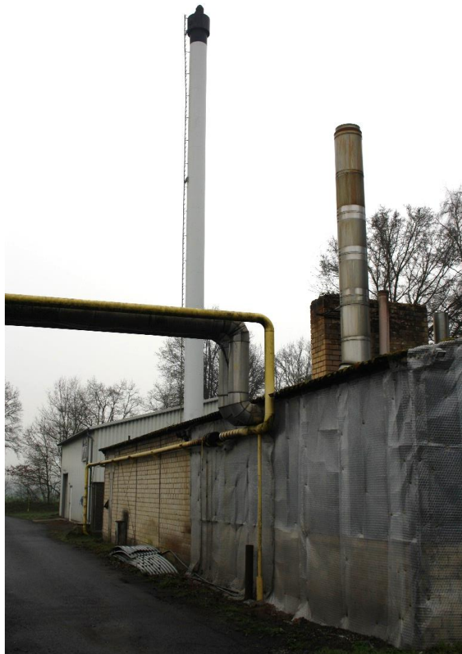
Abbildung 2.6: Gebäude mit Heizungsanlage
