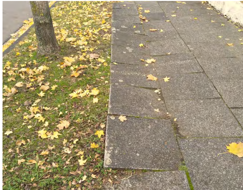
Abbildung 5-18: Wurzelaufbruch an der Hengtestraße
